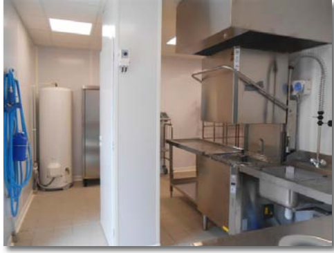
La cuisine satellite située à l'école élémentaire Patrus a été réaménagée : l'objectif étant de rendre plus fonctionnelle la zone de préparation des repas et la laverie.
