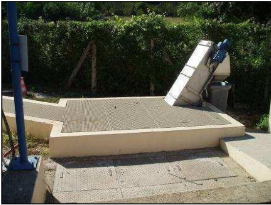
PR Bas avec dégrilleur
