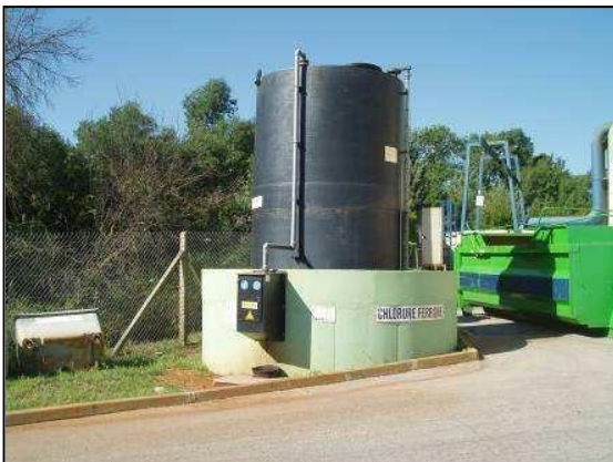
Cuve de Chlorure ferrique
