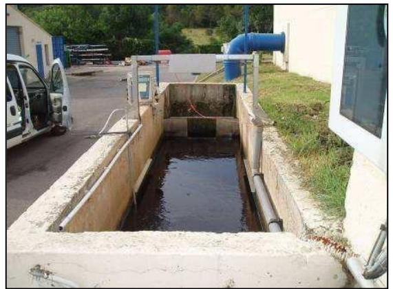
Canal de sortie
